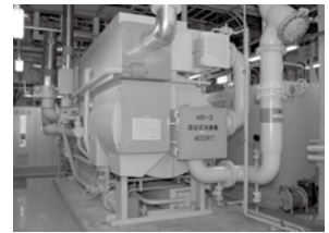
蒸気吸収式冷凍機
