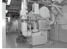
ターボ冷凍機
