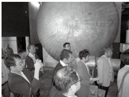
Bangsar 地冷センター
