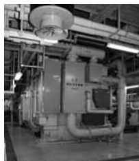
■蒸気吸収式冷凍機
