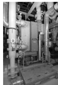
排熱投入型蒸気吸収式冷凍機(超省エネジェネリンク)
