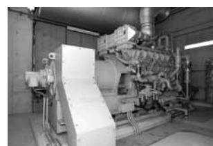
非常用発電機(プラント側)
