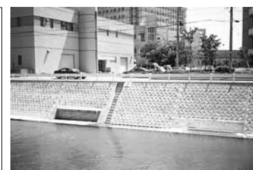
取・放水口設備
