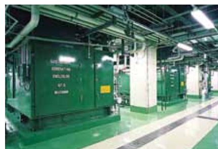
ガスタービン発電機
