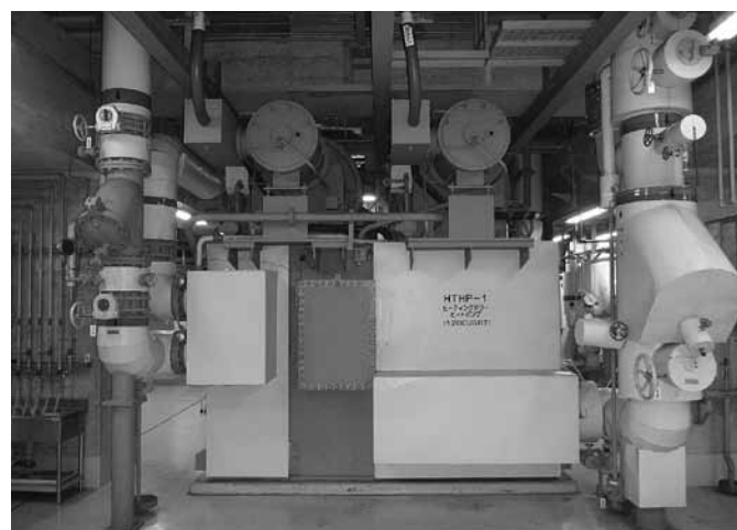
ヒーティングタワーヒートポンプ
