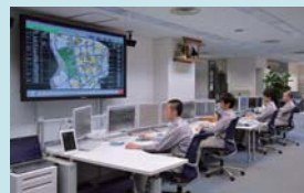
コントロールルーム
