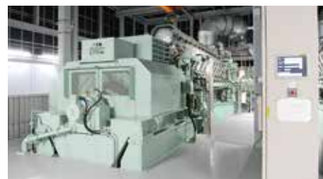
ガスエンジン (5,770kW×6基)
