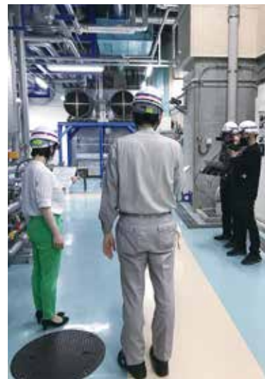
プラントからの配信の様子
