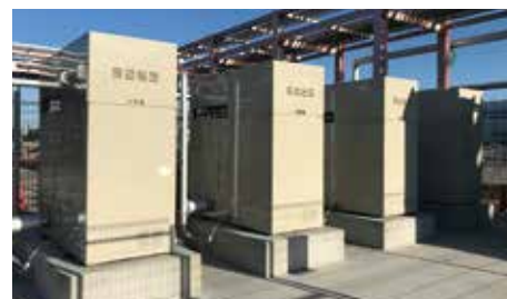
カルビー新宇都宮工場に設置されたバイオガス発電設備 (25kW×4基)
