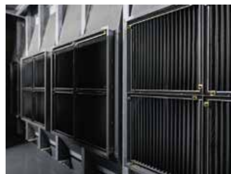
火山灰フィルターが装着された吸気口
