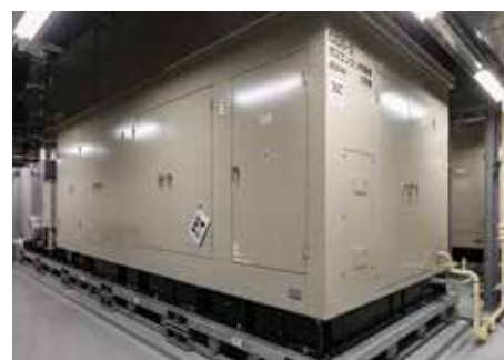
ガスエンジンコージェネレーションシステム (800kW×2基)
