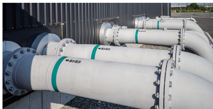
海水取水配管
