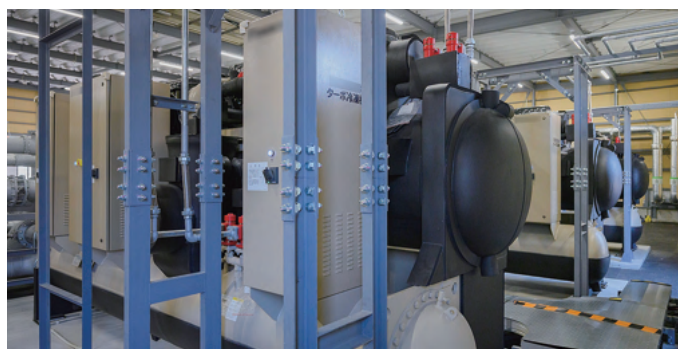
ターボ冷凍機
