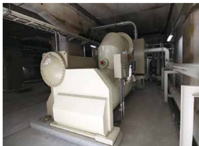
インバーターターボ冷凍機（第1プラント）
